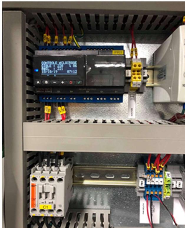
Figure 23 - Système de contrôle de l'éclairage
